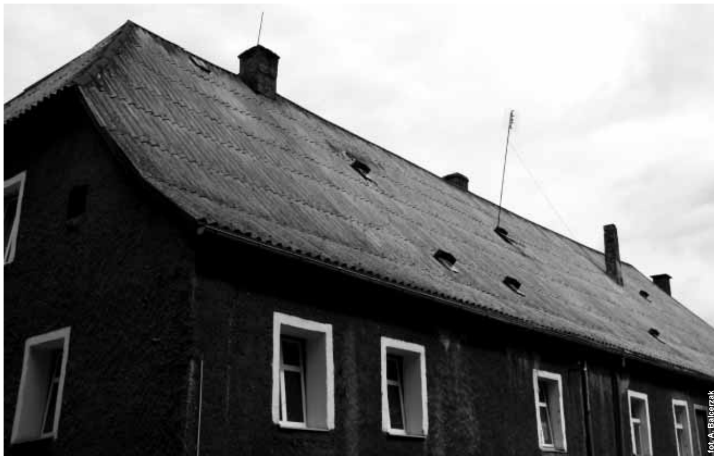
Dach budynku przy ul. Fredry w Nowej Rudzie pokryty jest azbestem
